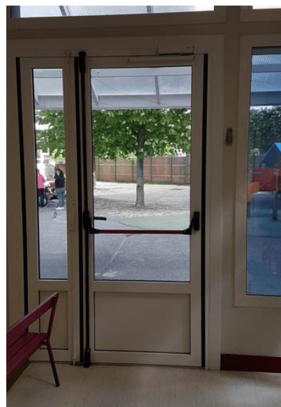
Porte de secours PMR
